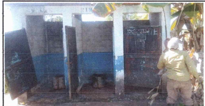
FOTO 6 . SE OBSERVA EL MODULO DEL BAÑO DE LOS NIÑOS, PARED EXPUESTA A LA HUMEDAD Y SU ESTRUCTURA CON INICIOS DE DERRUMBES.
