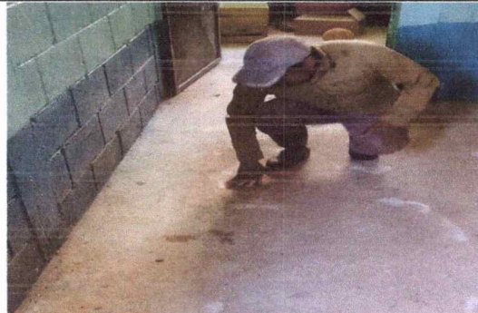
FOTO 2. SE OBSERVA LAS CONDICIONES DEL PISO DE LAS AULAS, LA HUMEDAD HA FAVORECIDO LA PROPAGACION DE MOHOS.
