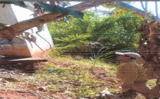
FOTO 3. SE OBSERVA EL DESLIZAMIENTO DE LAS ESTRUCTURAS DE LAS LETRINAS DE POSO SECO QUE AUN EN SUS CONDICIONES LOS NIÑOS HACEN USO.
